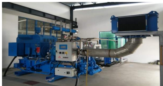
余热回收装置
